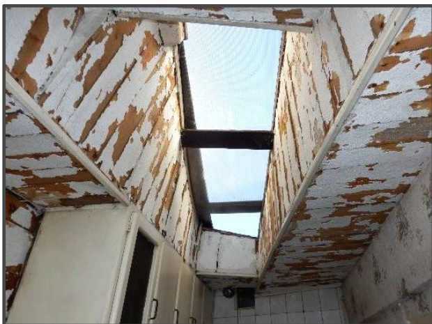
Plafond de la cuisine avec jour apparent sur les combles
