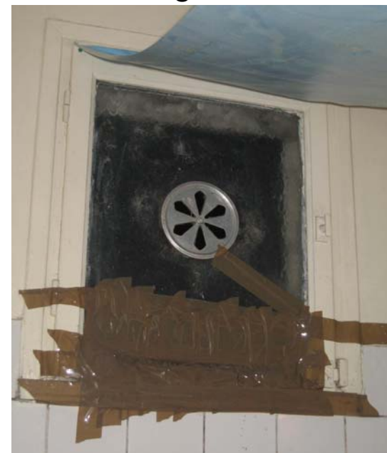
Bouche d'aération obstruée, colmatée
